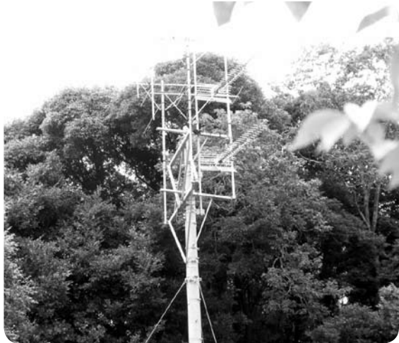
完成した地デジ用共同アンテナ (中央団地)
